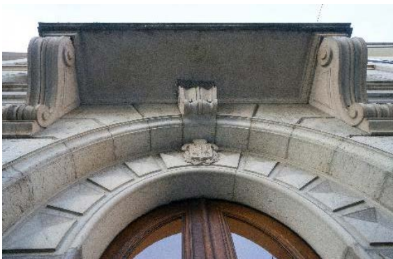
Façade nord-est, armoires, consoles (le millésime d'origine : 1844 est gravé sous les armoiries)
