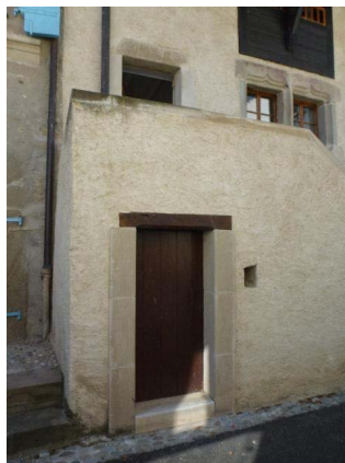
Détail porte à linteau droit et piédroits en pierre de taille, façade est
